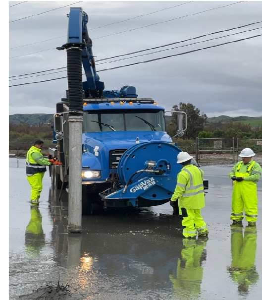
El Prado Sludge Line Break
